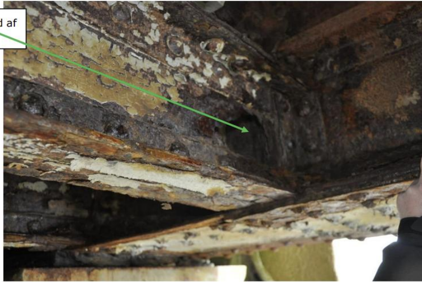
Figur 1: Korrosion på tværdrager.
